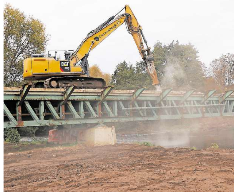
Zerlegen und abtransportieren: Aktuell wird die Betondecke der Rurbrücke in Einzelteilen entfernt. FOTO: KRISTINA TOUSSAINT
